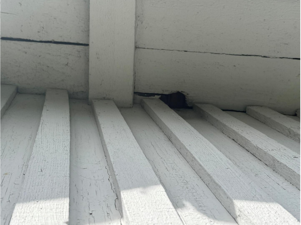
Kuva 2.4. Kalustajantalon katon ja seinän rajalle oli muodostunut mahdollisesti oravan tekemä kolo, josta lepakoiden olisi mahdollista päästä välikattotilaan.
