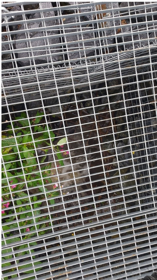
Kuva 6: Imukaivossa ei ole kantta, vaan virtaus johtuu kaivoon kivikorien läpi suoraan ylimmän kaivonrenkaan reunan yli.
