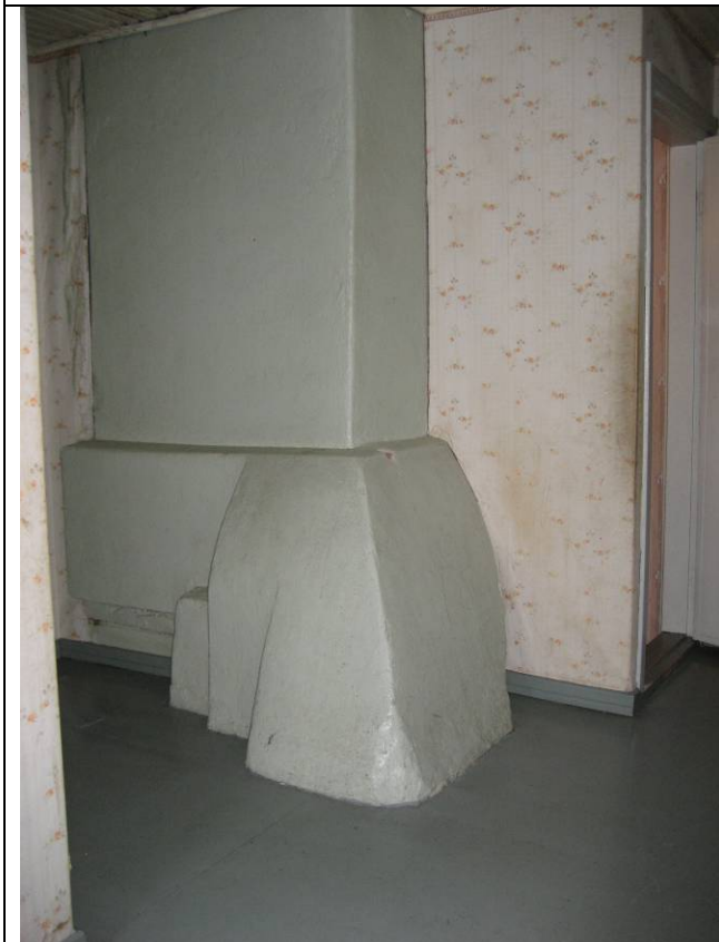
431-6-29 Haljastennokka 2009. Hormi yläkerrassa 2009.
