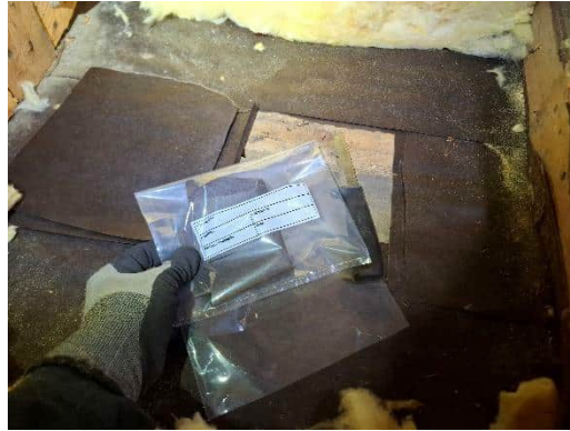
Kuva 14. Näyte HA24, RA YP 2. Tehdassalin yläpohjan tervapaperin PAH(16)-yhdistepitoisuudet eivät ylitä vaarallisen jätteen raja-arvoja.
