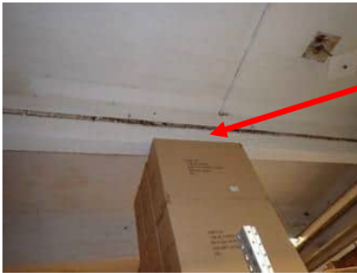
Kuva 45. Vanhoja piettyjä sähköjohtojen suojapunoksia. Suojapunokset saattavat sisältää asbestia ja PAH-yhdisteitä. Näytteenotto vaatii irtikytken varmistamisen.
