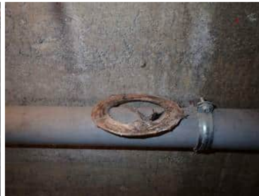
Kuva 21. Tehdasalueen alla kulkeva putkitunneli. Yksittäinen irrallinen kuitupohjainen, todennäköisesti asbestia sisältävä tiivisterengas muovisen viemäriputken päällä.
