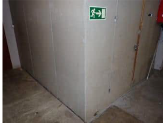
Kuva 5. Tehtassalin puhelinjakamo. Väliseinien verhoilun kuitusementtilevyt sisältävät asbestia.
