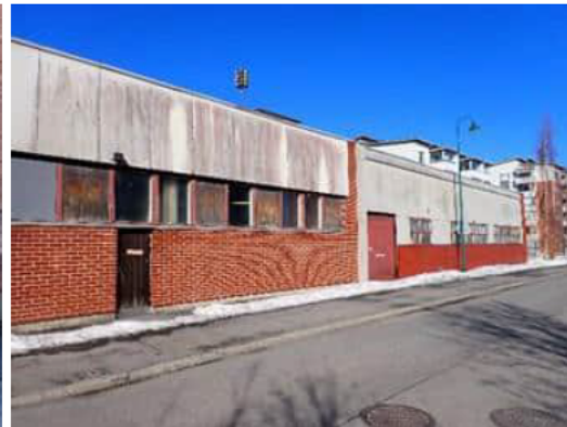
Kuva 3. Laajennusosan itäjulkisivu. Kuitusementtilevyt sisältävät krysotiili-asbestia.
