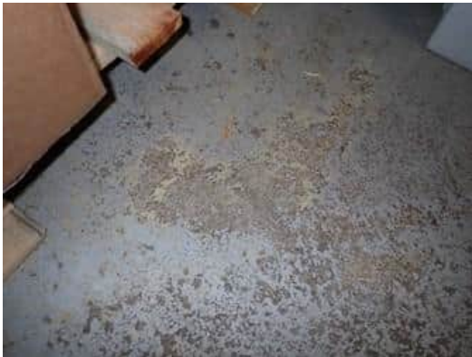
Kuva 14. Ensimmäisen kerroksen tehdassali. Lattian maalipinnoitteet sisältävät raskasmetalleja.
