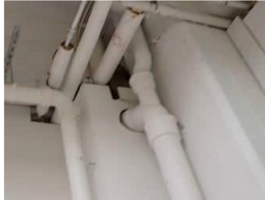
Kuva 44. Ensimmäisen kerroksen tehdassalin valurautaisia putkia, joiden muhviilitokset sisältävät metallista lyjyä.
