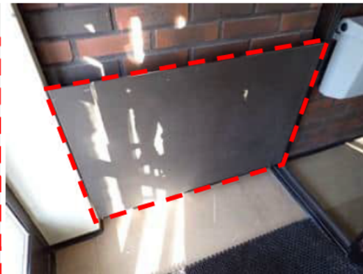
Kuva 7. Ensimmäisen kerroksen tuulikaappi. Lämmönluovuttimen suojan kuitusementtilevy sisältää asbestia.
