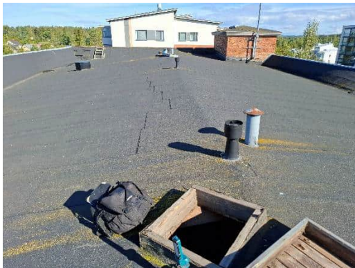
Kuva 15. Näytteet HA25, HA26, ja HA27. Tehdassalin vesikaton bitumikermit eivät sisällä asbestia eikä niiden PAH(16)-yhdistepitoisuudet ylitä vaarallisen jätteen raja-arvoja.
