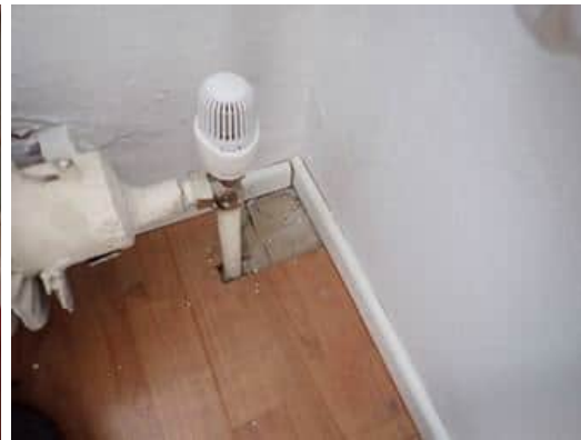
Kuva 17. Näyte HA11, lounaisnurkan työhuoneet. Uusittujen pintamateriaalien alla oleva musta kiinnitysliima sisältää antofylliittiasbestia.
