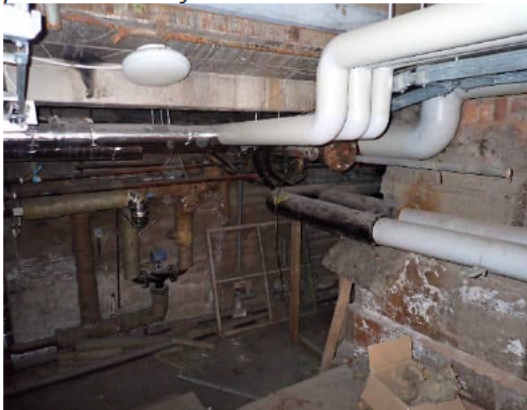
Kuva 21. Yleiskuva putkikanaaliin kulkevista putkista. Putket on eristetty paljain sekä muovikalvolla pinnoitetuin mineraalivillakouruin. Vanhoja mahdollisesti asbestipitoisia putkieristeitä ei havaittu.
