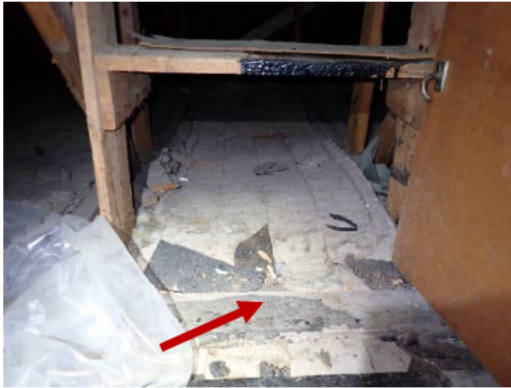
Kuva 1. Näyte HA2. Toimistosiiven yläpohjan eristetilassa lojuvat bitumikermit eivät sisällä asbestia, eikä niiden PAH(16)-yhdistepitoisuus ylitä vaarallisen jätteen raja-arvoa.
