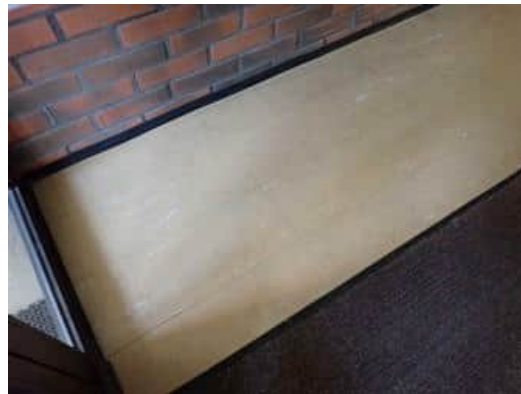
Kuva 11. Asbestipitoisia lattiavinyylilaattoja porrashuoneen lattialla.
