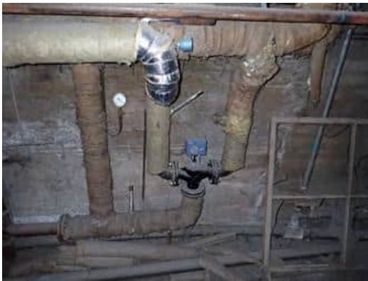
Kuva 20. Tehdasalueen alla kulkeva putkitunneli. Putkistojen laippaliitokset sisältävät todennäköisesti asbestia.
