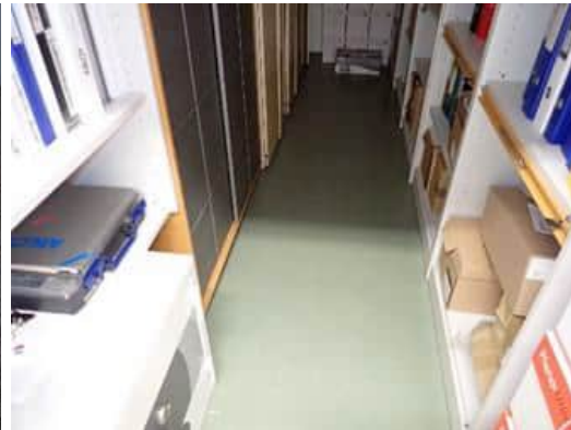
Kuva 15. Kolmannen kerroksen arkistohuone. Lattian maalipinnoitteet sisältävät raskasmetalleja.
