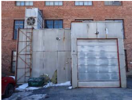
Kuva 2. Näyte HA1, varastokoppi. Kuitusementtilevyt sisältävät krysotiili-asbestia.
