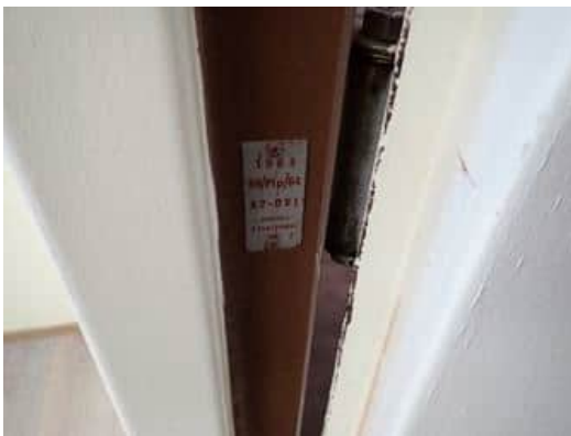
Kuva 22. Rakennuksen alkuperäiset 1960...80-luvuilla asennetut teräspalo-ovet ja niiden karmit sisältävät rakennusajankohdan perusteella asbestia.
