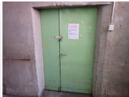
Kuva 23. Rakennusajankohdan perusteella asbestia sisältävä teräspalo-ovi.
