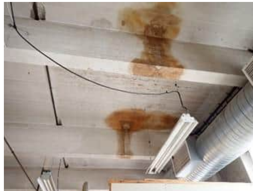
Kuva 36. Kuntosalin välipohjarakenne. Välipohjarakenteessa on alapinnassa havaittavissa todennäköisesti vuodoista aiheutuneita öljyvaurioita.
