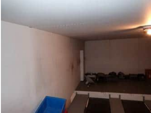
Kuva 8. Toimistosiiven kolmannen kerroksen arkistohuone. Seinä- ja kattopintojen kuitusementtilevyt sisältävät asbestia.
