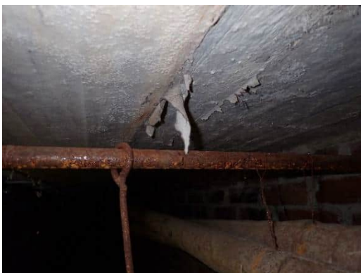
Kuva 11. Näyte HA20, tehdasalueen alapuolinen putkitunneli. Betoniholvin alapinnassa olevat harsokankaan jäämät eivät sisällä asbestia.
