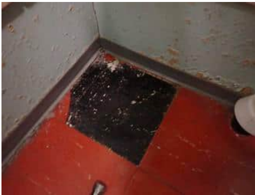
Kuva 16. Näyte HA15, toimistosiiiven kolmannen kerroksen WC-tilat. Lattiavinyyliilaattojen alla oleva musta kiinnitysliima sisältää antofylliittiasbestia.
