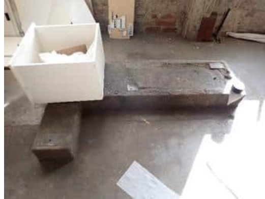
Kuva 34. Toisen kerroksen vanha betoninen laitepeti. Laitepedin ympärillä on aistinvaraisesti öljyiseksi arvioitua betonia
