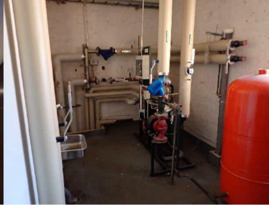
Kuva 20. Yleiskuva uusitusta lämmönjakuhuoneesta. Vanhoja mahdollisesti asbestia sisältäviä kattilahuoneen rakenteita ei havaittu.
