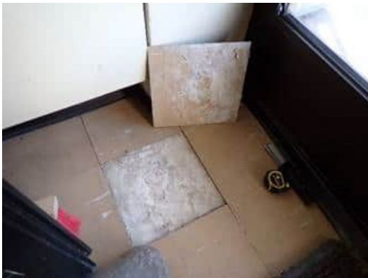
Kuva 10. Näyte HA4, tuulikaapin aula. Lattiavinyylilaatta sisältää krysotiiliasbestia.
