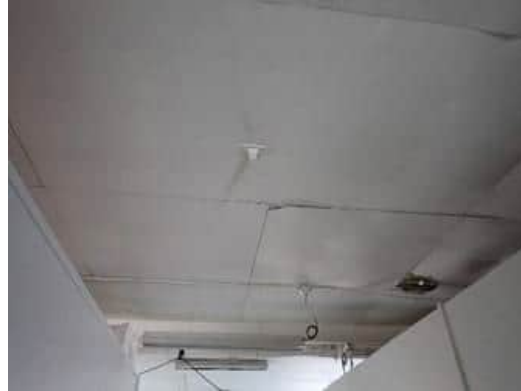
Kuva 9. Tehdassalien kolmas kerros. Sisäkaton alapinnan kuitusementtilevyt sisältävät asbestia.
