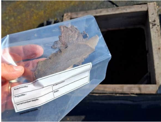
Kuva 13. Näyte HA23, RA YP 1. Tehdassalin yläpohjan tervapaperin PAH(16)-yhdistepitoisuudet eivät ylitä vaarallisen jätteen raja-arvoja.
