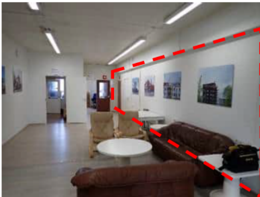
Kuva 6. Näyte HA12, toimistosiiven kolmas kerros. Väliseinän kuitusementtilevyt sisältävät krysotiili-asbestia.
