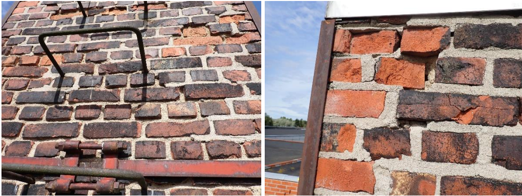
Kuva 39. Piipun tiilimuurauksessa on runsaasti pakkasrapautuman vaurioittamia tiiliä, niissä on runsaasti halkeamia, lohkeamia ja useita putoamisvaarassa olevia osittain irti olevia paloja. Koputteluvaste on pääosin pehmeä ja samea. Tarkastuksen yhteydessä poistettiin useita tippumisvaarassa olleita tiilenpaloja.
