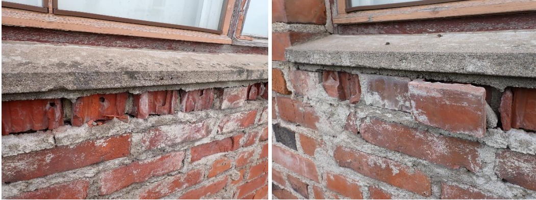
Kuva 20. Kuvassa länsisivulla olevien ikkuna-aukkojen alapuolella tiilijulkisivun vaurioita. Tiilissä ja muuraussaumoissa pakkasrapautuman aiheuttamaa vaurioitumista.
