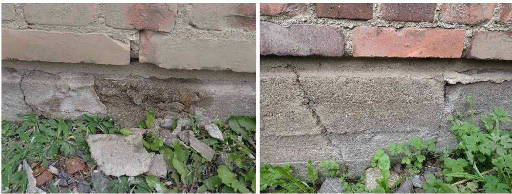
Kuva 11. Länsisivun sokkeli on osittain pinnastaan tasoitettu. Tasoite on monin paikoin irronnut alustastaan ja alla oleva betoni on pinnastaan silminnähden rapautunutta. Oikealla kuvassa sokkelin kuivumiskutistumaan viittaavia pystysuuntaisia halkeamia.
