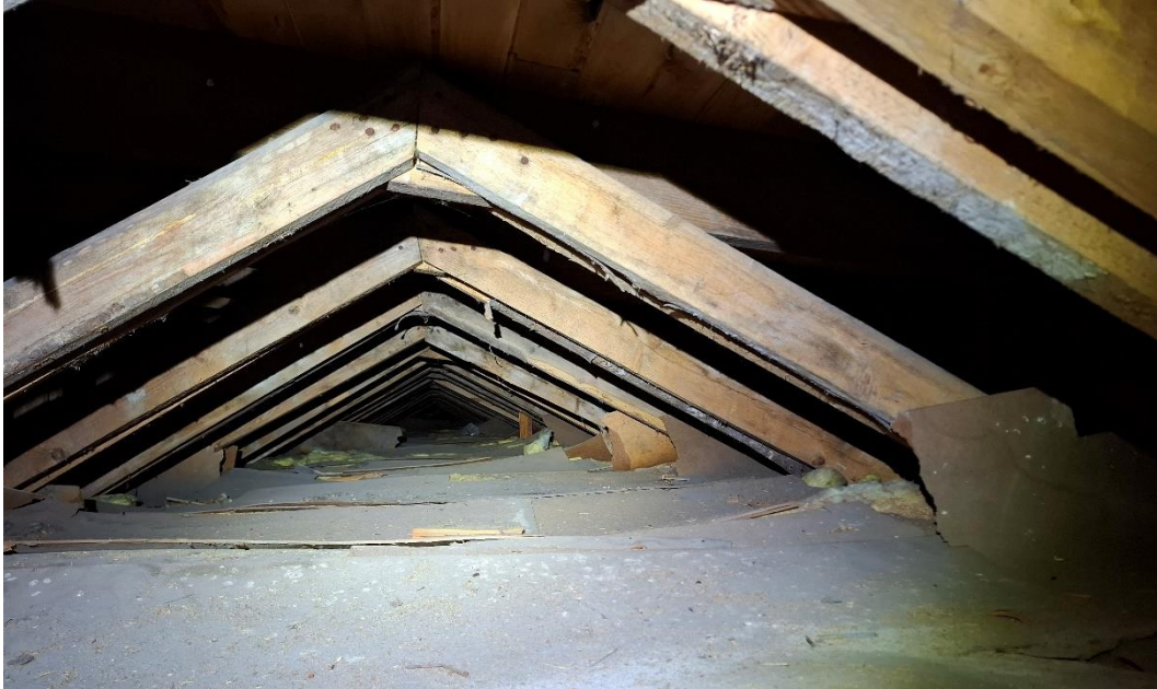
Kuva 57. Yleiskuvat yläpohjan tuuletusvälistä tehdassalin pohjoisen puoleisessa päädyssä rakennemuutoksen RA1 kohdalta. Vanhojen kattoristikoiden väliin on lisätty uudet kattoristikot. Mineraalivillan päällä on kauttaaltaan sahanpurua ohut kerros. Puurakenteissa on laajasti vanhoja kosteusjälkiä, tummentumaa sekä homepilkkuja. Vesikaton aluslaudoitus on paikallisesti todennäköisesti uusittu. Osin puurakenteena on käytetty vanhaa betonimuottiputavaraa.
