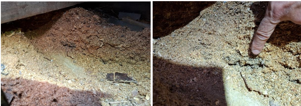
Kuva 73. Sahanpuru on rakenneavauksen RA5 kohdalla tummentunut ja paakkuuntunut.
