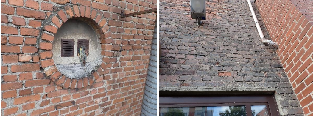
Kuva 23. Tehdasosan pohjoispäässä sijaitsevan torniosan yläosassa sekä itäisivulla sijaitsevan sisäänkäynnin yläpuolella runsaasti rapautuman vaurioittamia tiiliä, julkisivuosien koputteluvaste on pääosin pehmeä ja samea.
