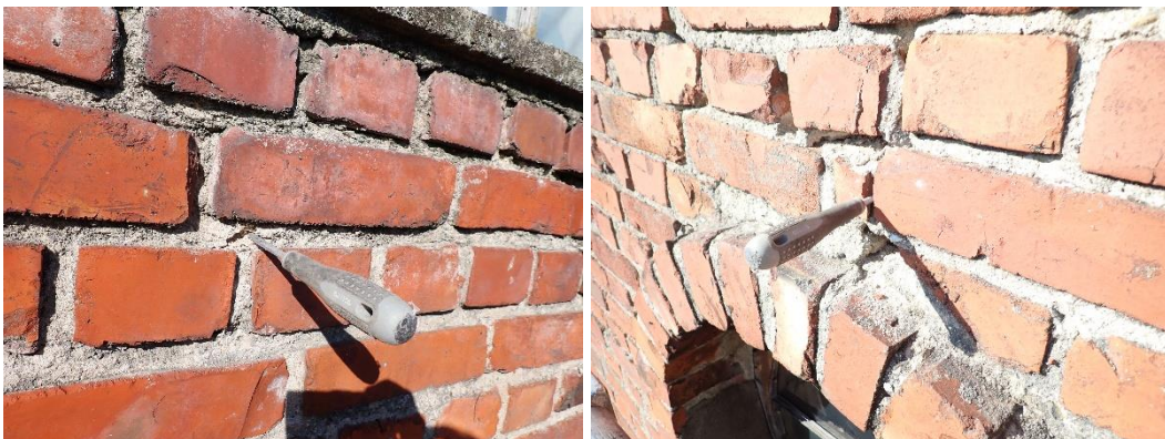
Kuva 25. Itäisivulla muuraussaumoissa rapautumaan ikkuna-aukkojen alapuolisissa saumoissa sekä torniosan yläosan saumoissa.
