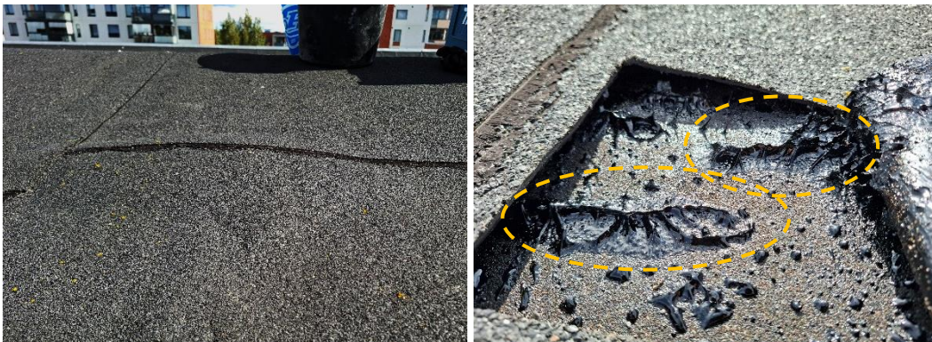
Kuva 50. Kermi avattiin yksittäisen suurehkon höyrypussin kohdalta. Pintakermi on irti pohjakermistä. Pinta- ja pohjakermin välissä on vain paikoin liimausbitumia ja pohjakermin hiekkasirotepinta on näkyvissä. Liimausbitumi on paikoin muotoutunut kraaterimaiseksi (ympyröity keltaisella katkoviivalla).
