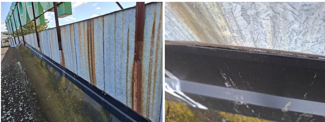
Kuva 53. Ylösnostojen suojapeltien yläreuna on epätiivis, pellin ja seinän välissä on rako. Vastaavia puutteita on pääosin kaikissa ylösnostoissa seinäpinnoille.
