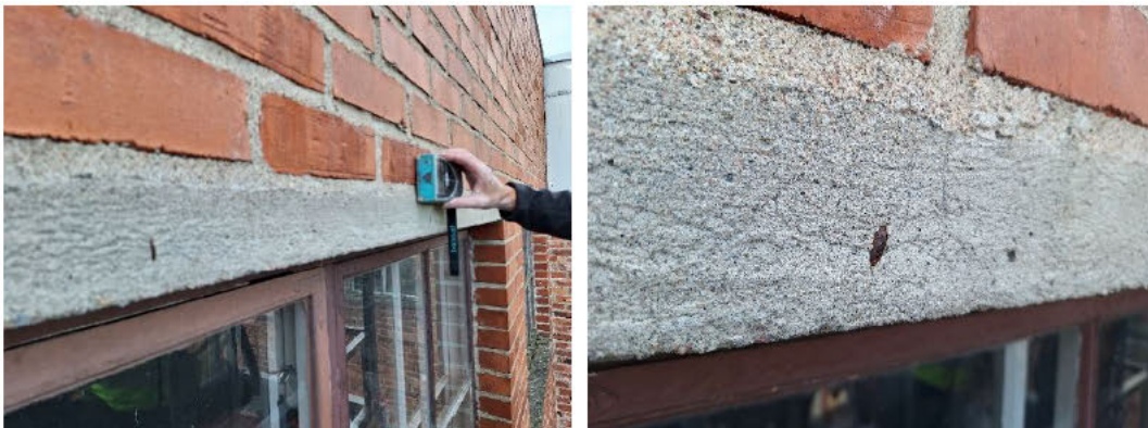
Kuva 16. Korotetun osan ikkunapalkeissa on paikoin lähellä pintaa olevia hakaraudoituksia, joissa on pintakorrosiota.
