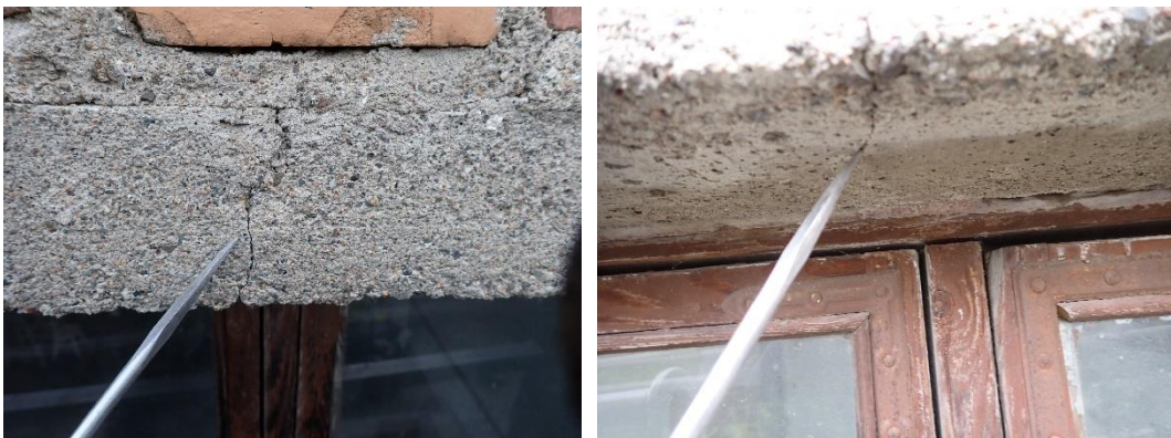
Kuva 19. Alkuperäisen osan ikkunapalkeissa havaittiin yksittäisiä rakenteen läpi ulottuvia halkeamia.
