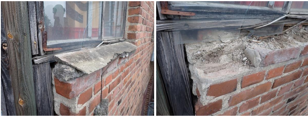
Kuva 28. Osa länsisivun ikkunoista ja betonirakenteisista vesipenkeistä on erittäin huonossa kunnossa ja aiheuttavat turvallisuusriskin kiinteistössä asioiville sekä länsisivun julkisivun läheisyyteen pysäköidyille ajoneuvoille. (kuvassa irtonaisena olleet lasiruudut sekä betonirakenteinen vesipenkki poistettiin julkisivututkimuksen yhteydessä).
