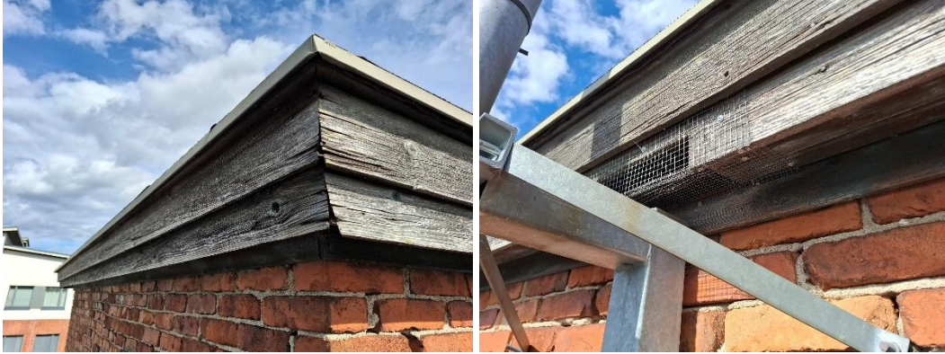
Kuva 71. Räystäslaudat ovat harmaantuneet ja halkeilleet. Yläpohjan tuuletus on järjestetty räystäslautojen rakojen kautta sekä yksittäisen isomman aukon kautta, jonka päälle on asennettu pieneläinverkko.
