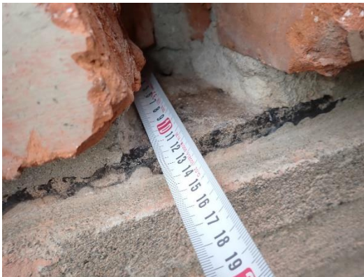
Kuva 9. Sokkelin ylä- ja sisäpinnassa on bitumisively. Sivelyssä ei todettu asbestia tai PAH(16)-yhdisteitä yli vaarallisen jätteen raja-arvon (näyte HA28, AFRY Finland Oy, 10.10.2025).
