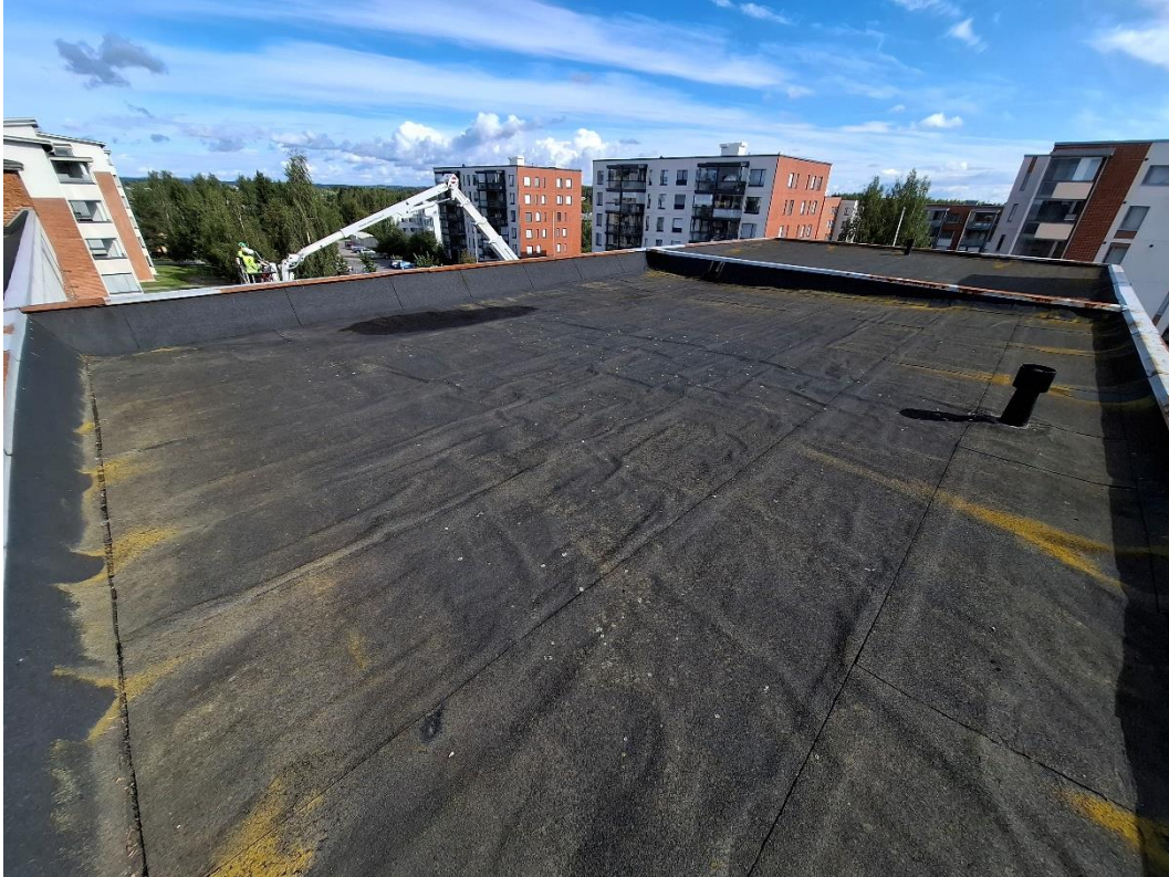
Kuva 46. Yleiskuva porrashuoneen katosta. Kermi on voimakkaasti poimuuntunut ja siinä on lukuisia höyrypusseja. Poimuja ja höyrypusseja on huomattavasti vähemmän palomuurin toisella puolella olevan katon itäpäädyn kohdalla.
