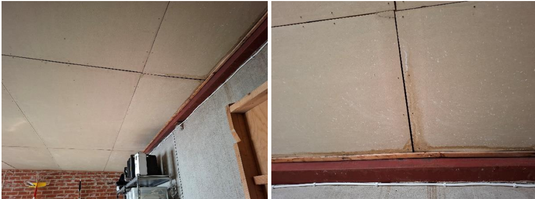
Kuva 67. Porrashuoneen kohdalla olevan varastotilan katossa on kosteusjälkiä sisäverhouslevyssä.
