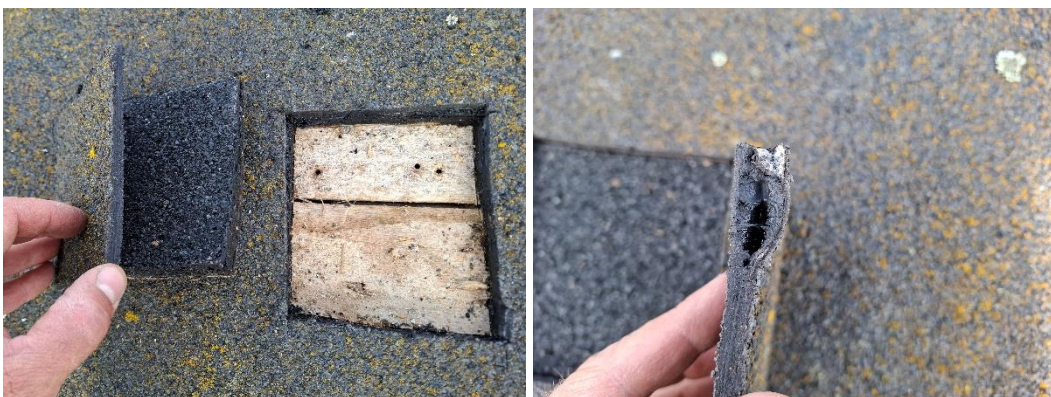
Kuva 70. Vesikatossa on yhteensä noin 4...5 bitumikermiä päällekkäin. Päällimmäiset kaksi kermiä on asennettu viimeisimmässä kerrin korjauksessa. Päällimmäiset kermit ovat irti alla olevista kermeistä. Päällimmäiset kermit ovat teknisesti hyväkuntoiset; kermit ovat lujia ja taipuisia ja kermit ovat hyvin kiinni toisissaan.
