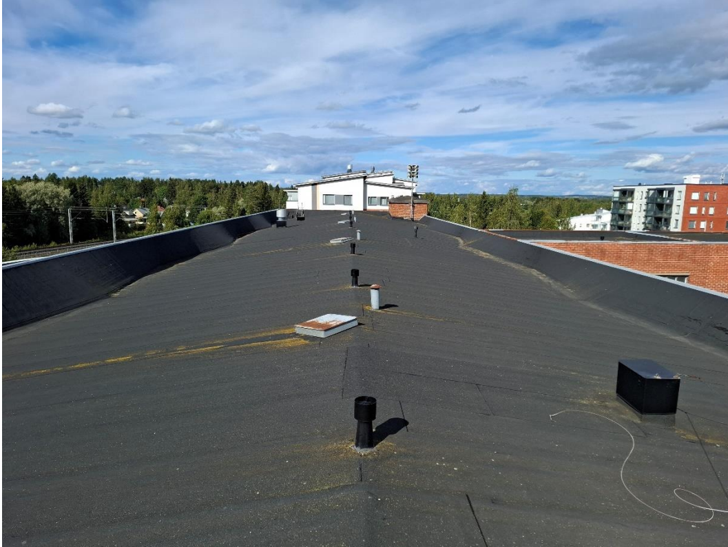
Kuva 45. Yleiskuva vesikatosta. Kuvan oikeassa reunassa näkyy porrashuoneen katto. Kuvan takaosassa näkyy hissikuilun katto.
