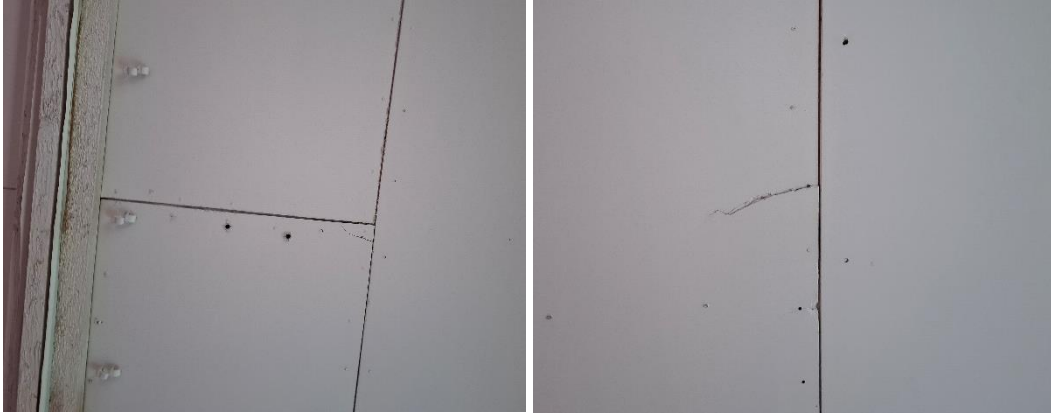
Kuva 65. Sementtikuitulevy on monin paikoin halkeillut ja siitä on lohkeillut palasia.
