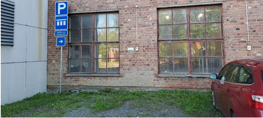
Kuva 7. Yleiskuva länsisivun sokkelista. Sokkeli on monin paikoin matala (alle 200 mm maanpinnasta).
