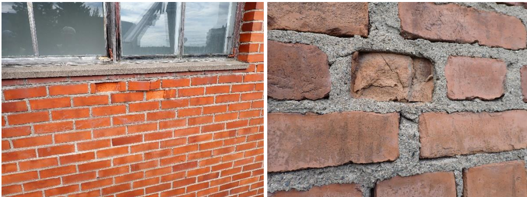
Kuva 22. Itäsiiven eteläsivulla pakkasrapautuman vaurioittamia tiiliä ikkuna-aukon alapuolen uudemmassa (vuodelta 1969) tiilimuurauksessa sekä alkuperäisessä (vuodelta 1946) muurauksessa.
