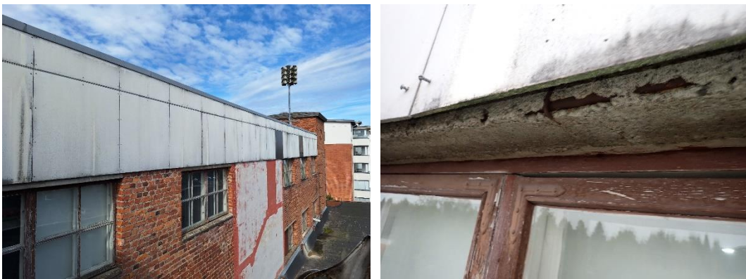
Kuva 18. Tehtaan vuonna 1965 korotetun osan ikkunapalkit ovat osittain räystään kuitusementtilevytyksen alla suojassa. Osa korotetun osan ikkunapalkeista on kuitenkin harvavaluisia, ja muutamassa länsijulkisivun ikkunapalkissa on näkyvillä näkyvissä pinnastaan korroosioaurioituneet teräkset.
