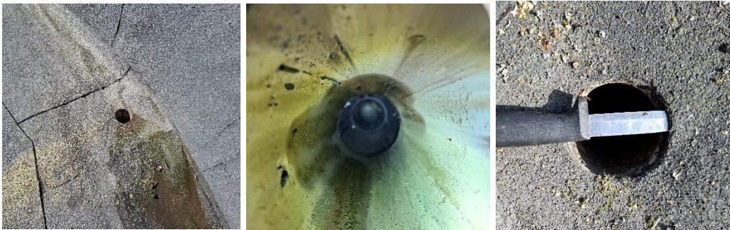
Kuva 52. Pääosasta kaivoja puuttuu roskasihdit. Kaivot on todennäköisesti uusittu saneerauskaivoina viimeksi tehdyn korjauksen yhteydessä, missä kermit on uusittu. Yksittäisen kaivon kohdalla kermi on paikallisesti irti kaivon laipasta.
