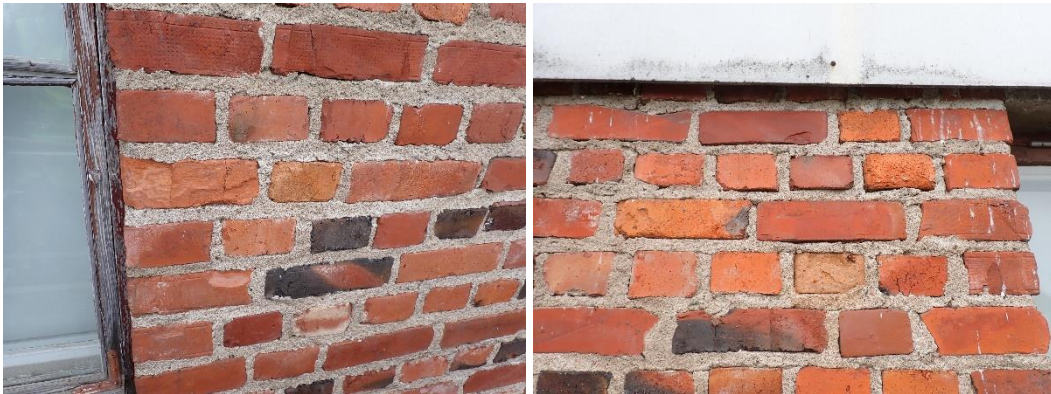
Kuva 21. Länsisivun yläosassa olevia pakkasrapautuman vaurioittamia tiiliä.
