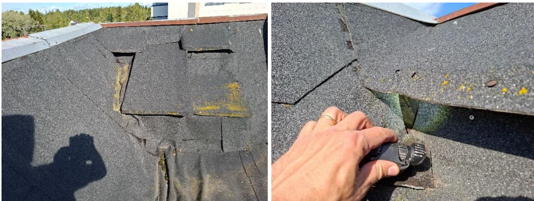
Kuva 49. Nurkkakohdalla kermin alustassa on porrastusta. Paikoin kermin saumat ovat auki ja saumasta on näkyvissä puualusta.
