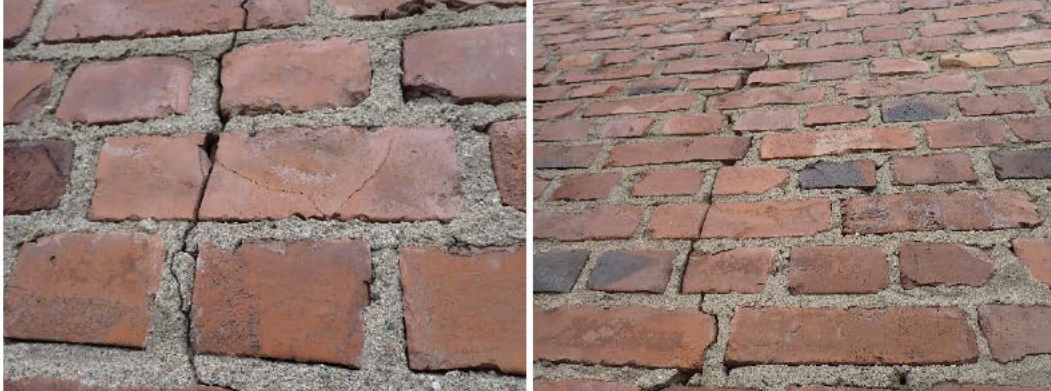
Kuva 26. Länsisivulla havaittu yksittäinen pidempi halkeama, joka pääosin noudattelee muuraussaumoja.
