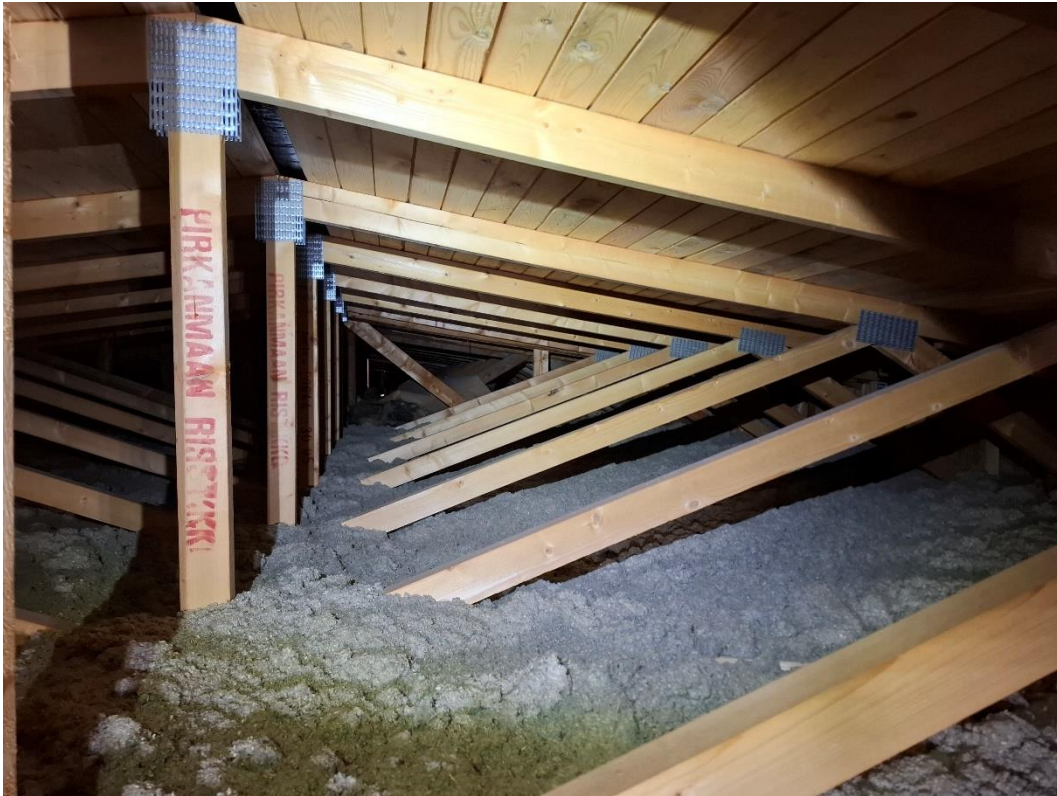
Kuva 59. Yleiskuva tehdassalin keskialueelta, missä vesikaton aluslaudoitus, puuristikkorakenteet, lämmöneriste, höyrynsulkumuovi ja sisäverhouksen koolaus on uusittu paikallisesti noin 5...10 metrin leveydeltä.
