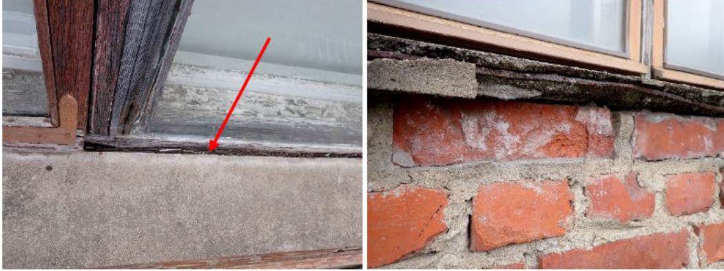
Kuva 30. Epätiivien vesipenkki- ja pielliittymien kautta seinärakenteen sisään päässyt sadevesi on aiheuttanut yhdessä pakkasrasituksen kanssa merkittäviä vaurioita ulkoseinärakenteille.
