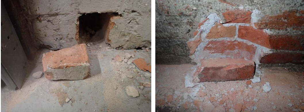
Kuva 36. Haitta-ainetutkimuksessa (AFRY Finland Oy, 10.10.2025) tutkittiin mm. tiiliseinien öljyhiilivetytypitoisuuksia. Öljyhiilivetytypitoisuudet ylittävät paikoin sisäilmariskien arvioinnissa sovellettavat kynnyksarvot.
