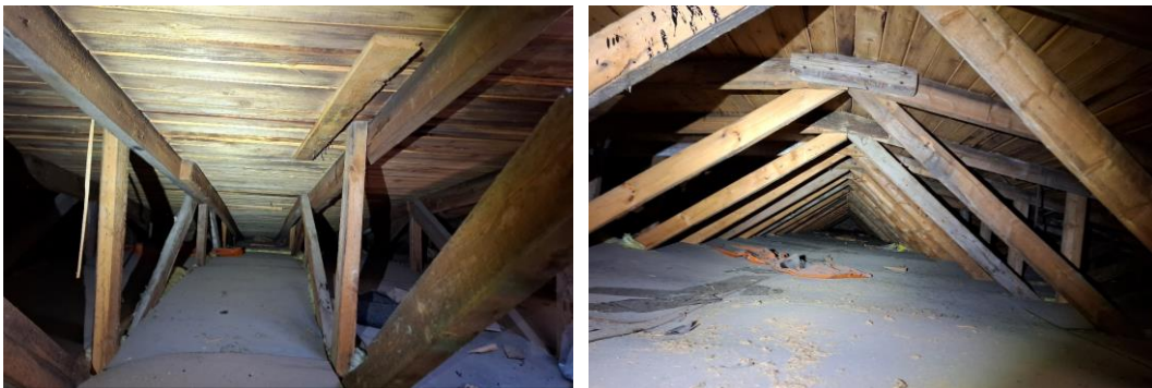
Kuva 58. Yleiskuvat yläpohjan tuuletusvälistä tehdassalin etelän puoleisessa päädyssä rakennemuutoksen RA2 kohdalta. Kattoristikoiden toteutustapa eroaa hieman pohjoispuolen toteutustavasta eikä mineraalivillan päällä ole sahanpurua, kuten pohjoispuolen päädyssä. Puurakenteissa on vanhoja kosteusjälkiä, tummentumaa sekä homepilkkuja, kuten pohjoispuolen päädyssä.
