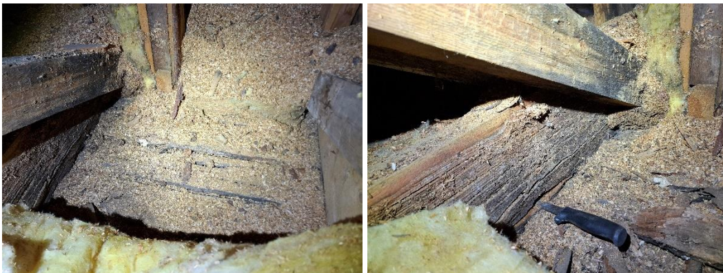
Kuva 60. Rakenneavaus RA1, jonka kohdalla havaittiin vanha pitkälle edennyt kosteusvaurio. Vaurion kohdalla on lahoa kantavan puuristikon alapaarteessa sekä yläpohjan alapinnan umpilaudoituksessa. Laudoitus oli ns. sormin purettavissa. Sahanpuru on paikallisesti tummunut ja paakkuuntunut. Kaikki rakenteet olivat tarkastushetkellä aistinvaraisesti arvioiden kuivia. Rakenneavauksen RA4 kohdalla havainnot olivat pääosin vastaavat kuin RA1 kohdalla sillä erotuksella, että rakenneavauksen RA4 kohdalla ei ollut lahovaurioita.
