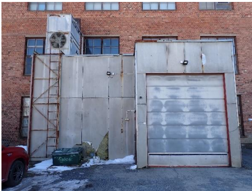
Kuva 37. Länsisivun varastokopin ulkoseinä on huonokuntoinen. Seinän ulkoverhous on tehty asbestipitoisella kuitusementtilevyllä (HA1, AFRY Finland Oy, 10.10.2025).
