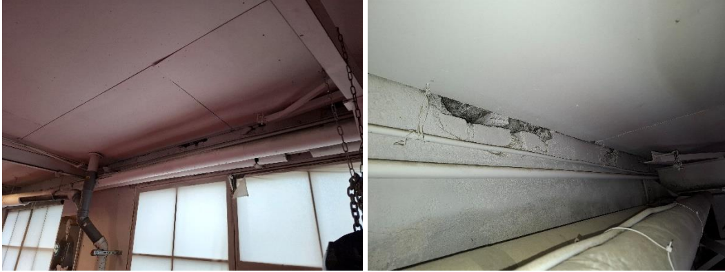
Kuva 68. Ulkoseinän ja yläpohjan liittymässä ulkoseinän sisäpinnan tasoite on monin paikoin lohkeillut.
