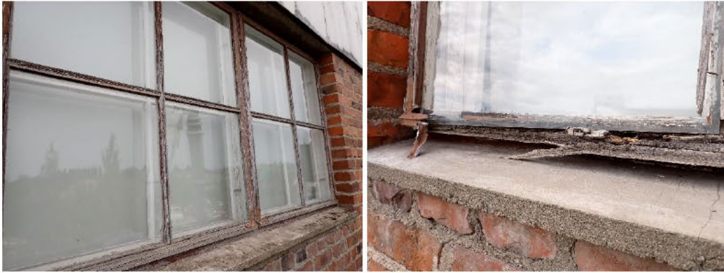
Kuva 31. Julkisivujen yläosissa merkittävästi lahovaurioituneita ulkopuitteita sekä yksittäisiä putoamisvaarassa olevia lasiruutuja (yksittäisiä putoamisvaarassa olleita lasiruutuja poistettiin julkisivujen kuntotutkimuksen yhteydessä).
