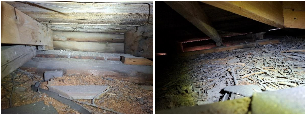
Kuva 72. Yleiskuvat yläpohjan tuuletusvälistä. Puurakenteissa on vanhoja kosteusjälkiä sekä tummentumaa. Yläpohjassa on paikallisesti runsaasti risuja (lintujen kuljettamia?)
