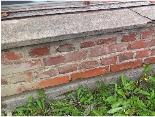
Kuva 10. Länsijulkisivun sokkeli on paikoin matala. Sokkelin pinnassa on näkyvissä rapautumista.
