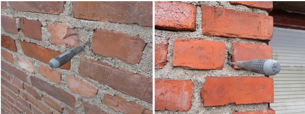
Kuva 24. Länsisivulla muuraussaumat erityisesti aukkojen alapuolella ja pielissä rapautuneita lähes koko syvyydeltään.
