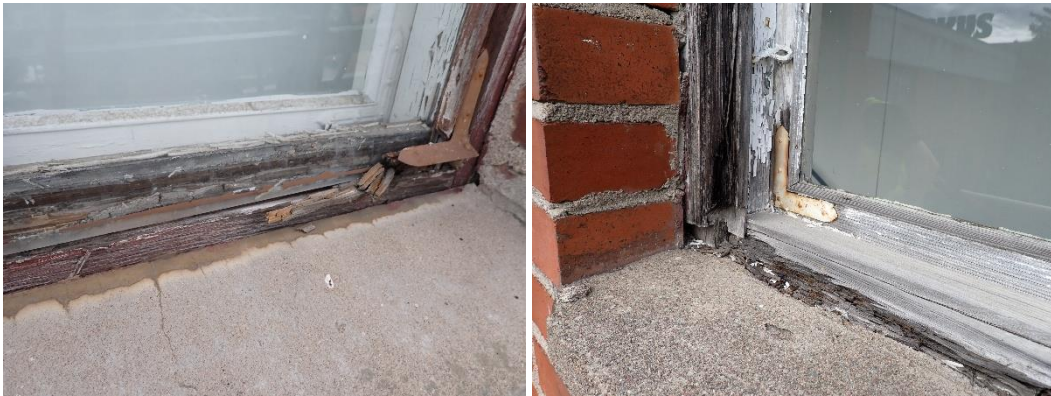
Kuva 29. Ikkunoiden ulkopokien puuosat ovat paikoin täysin lahonneet tai ulommainen ikkunapuite puuttuu kokonaan mahdollistaen sadeveden kulkeutumisen karmi- ja ulkoseinärakenteen sisään.
