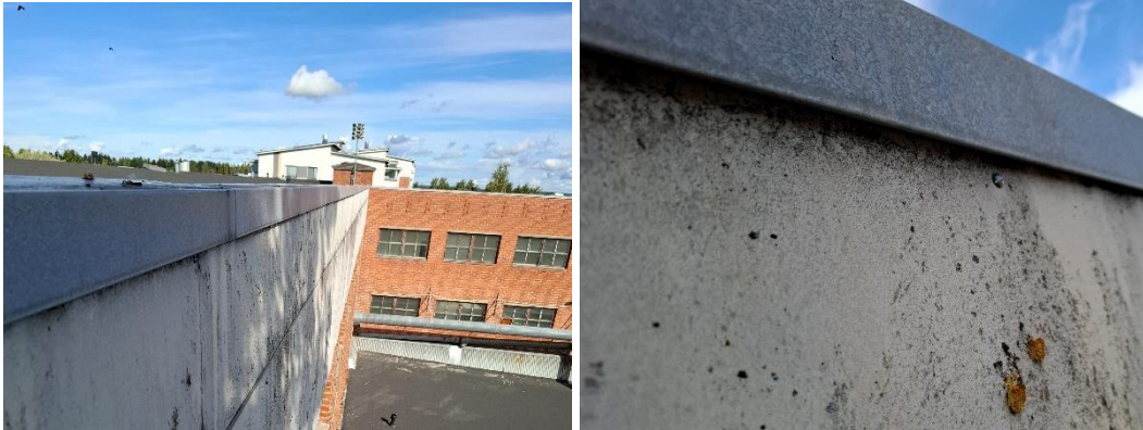
Kuva 54. Yleiskuva rakennuksen pitkän sivun räystäältä. Räystäällä ei ole selkeää tuuletusrakoa suojapellin ja julkisivuverhouselevyn välissä.
