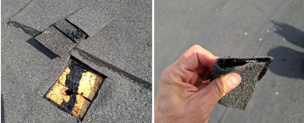
Kuva 51. Vesikatossa on yhteensä noin 4...5 bitumikermiä päällekkäin. Päällimmäiset kaksi kermiä on asennettu viimeisimmässä kermin korjauksessa. Päällimmäiset kermit ovat irti alla olevista kermeistä. Päällimmäiset kermit ovat teknisesti hyväkuntoiset; kermit ovat lujia ja taipuisia.
