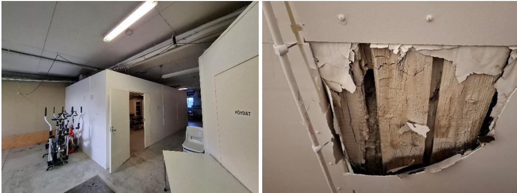
Kuva 66. Paikallinen pitkälle edennyt korjaamaton kosteusvaurio. Sementtikuitulevystä on lohjennut pala ja alta on paljastunut lahonneita lautoja. Laudat on maalattu valkoisella maalilla.
