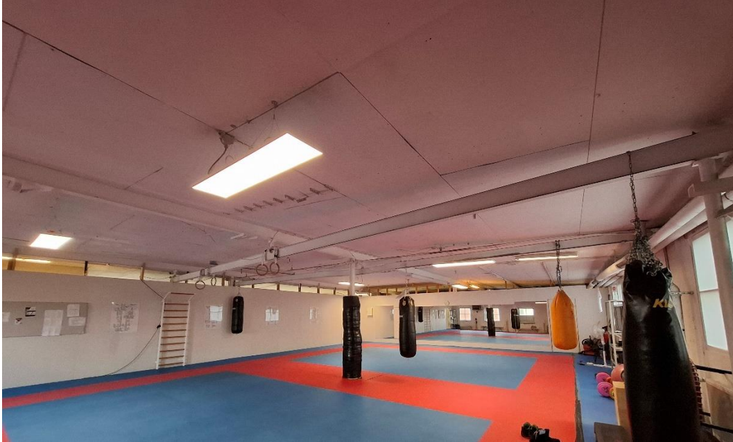
Kuva 63. Yleiskuva kolmannen kerroksen tilasta. Yläpohjan sisäverhouksena on kuitusementtilevy, joka lähtötietojen perusteella sisältää asbestia.
