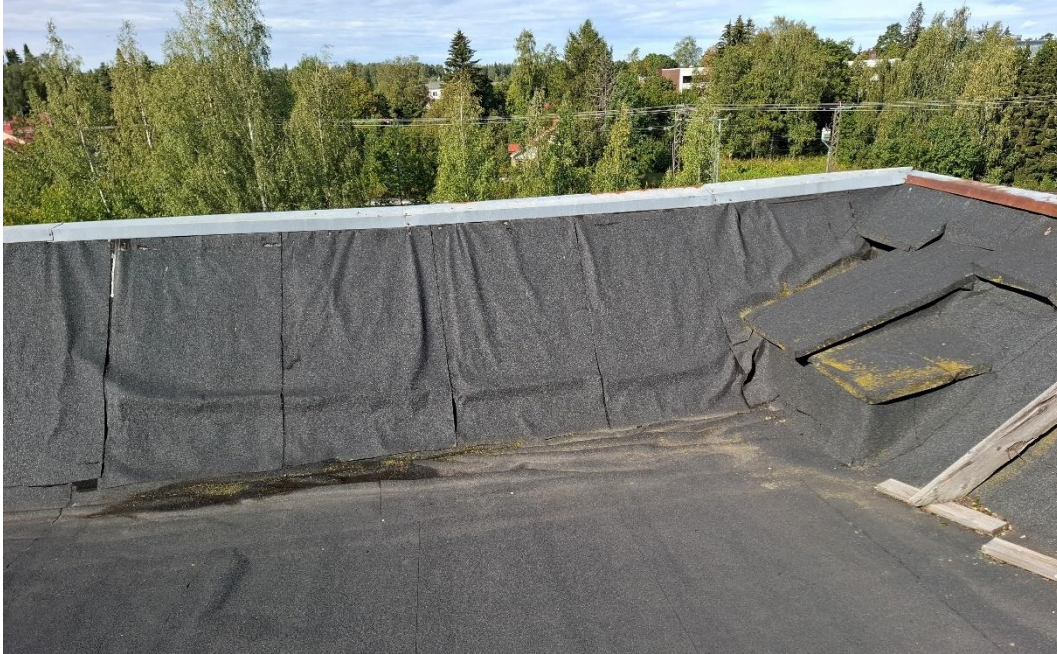
Kuva 48. Yleiskuva katon luoteisnurkan kohdalta, missä kermissä on runsaasti poimuja.
