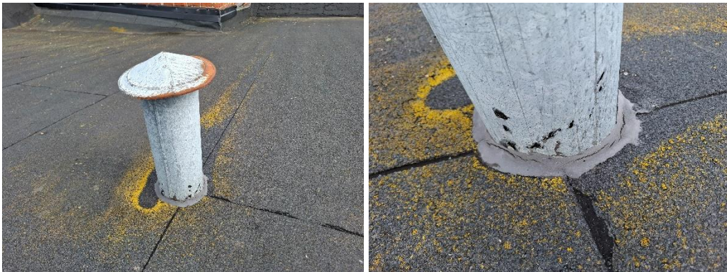
Kuva 55. Katolla on alipainetuulettimia, kattoluukkuja sekä yksittäisiä suurempia LVI-laitteita, joiden juuria on tiivistetty joustavalla saumamassalla. Saumamassa on paikoin ratkennut.
