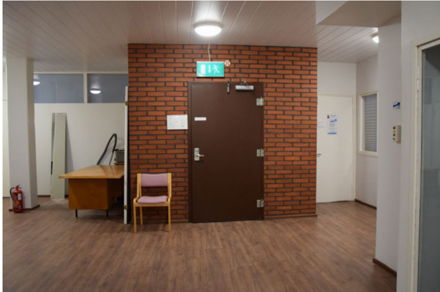
Kuva: Toisen kerroksen toimistoaulassa lattia on puukuvioista laminaattia ja seinät pääosin valkoisia, porrashuoneen seinien punatiili jäljittelee rakennuksen vanhoja osia.
