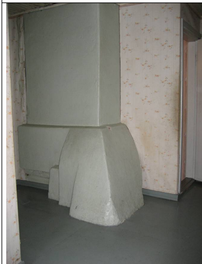
431-6-29 Haljastennokka 2009. Hormi yläkerrassa 2009.
