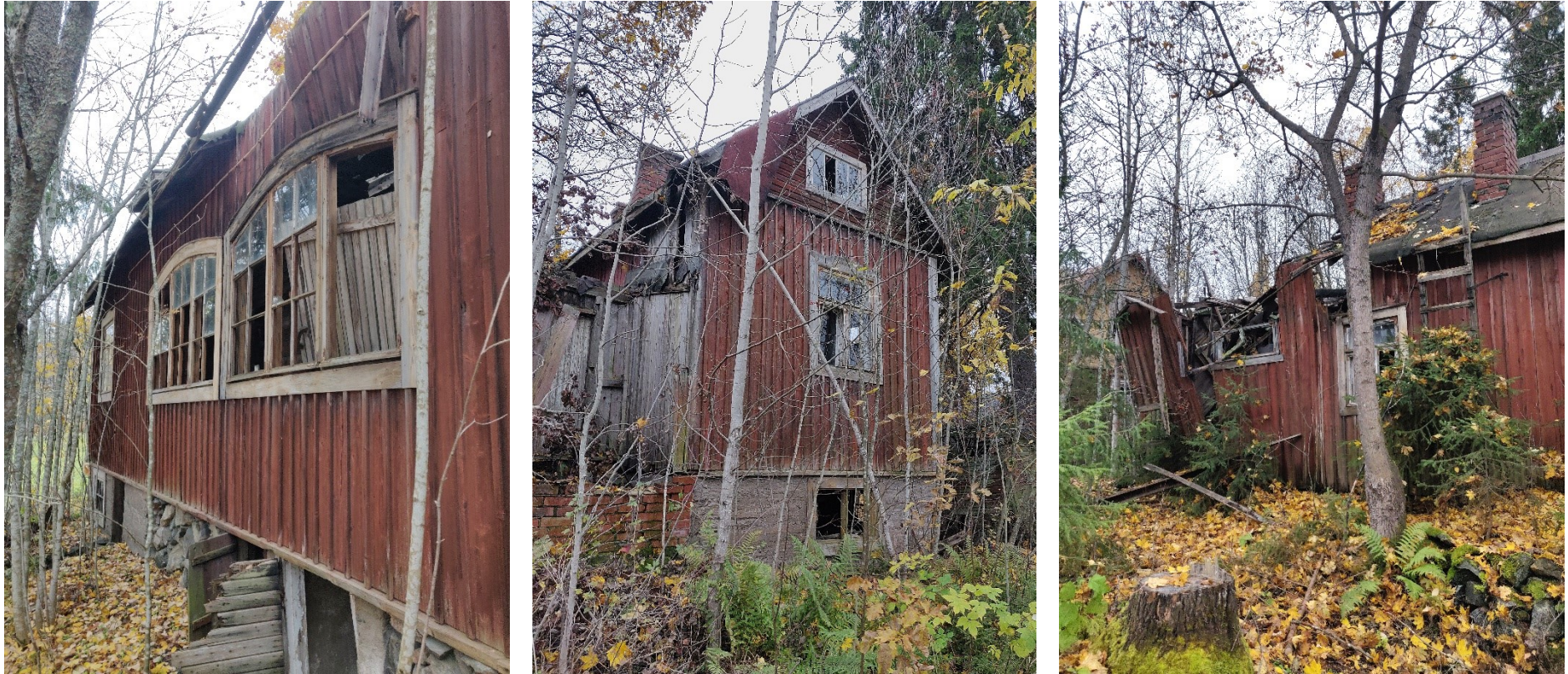
Kuva 20 Vasemmallla: Kaari-ikkunat ovat talusrakennuksen erityispiirre. Keskellä: Talusrakennuksen pohjoisjulkisivu. Oikealla: Talusrakennus on osin romahtanut.
