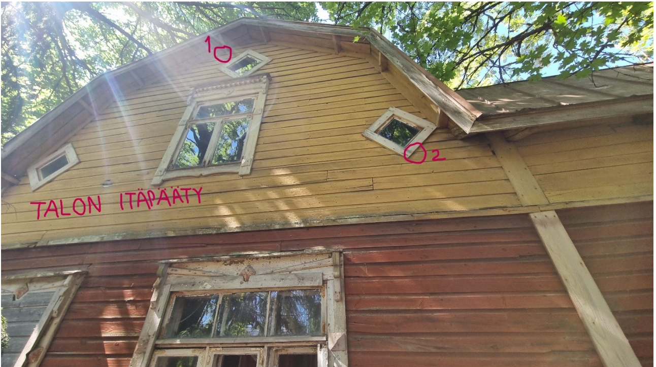
Kuva 10. Toisen Tarikantie 3 rakennuksen itäpäädyn yleiskuva, merkittyinä 2 koloa, joissa tarttumajälkiä.
