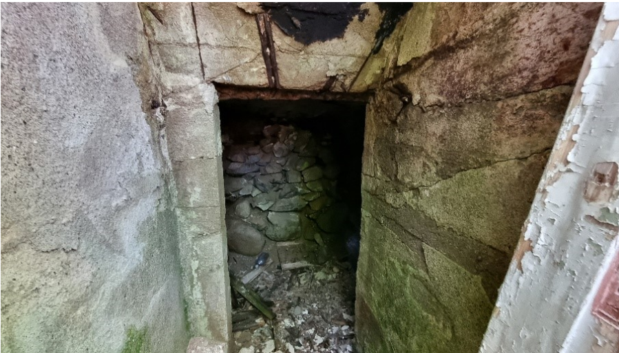
Kuva 9. Romahtaneen rakennuksen avointa kellaria.
