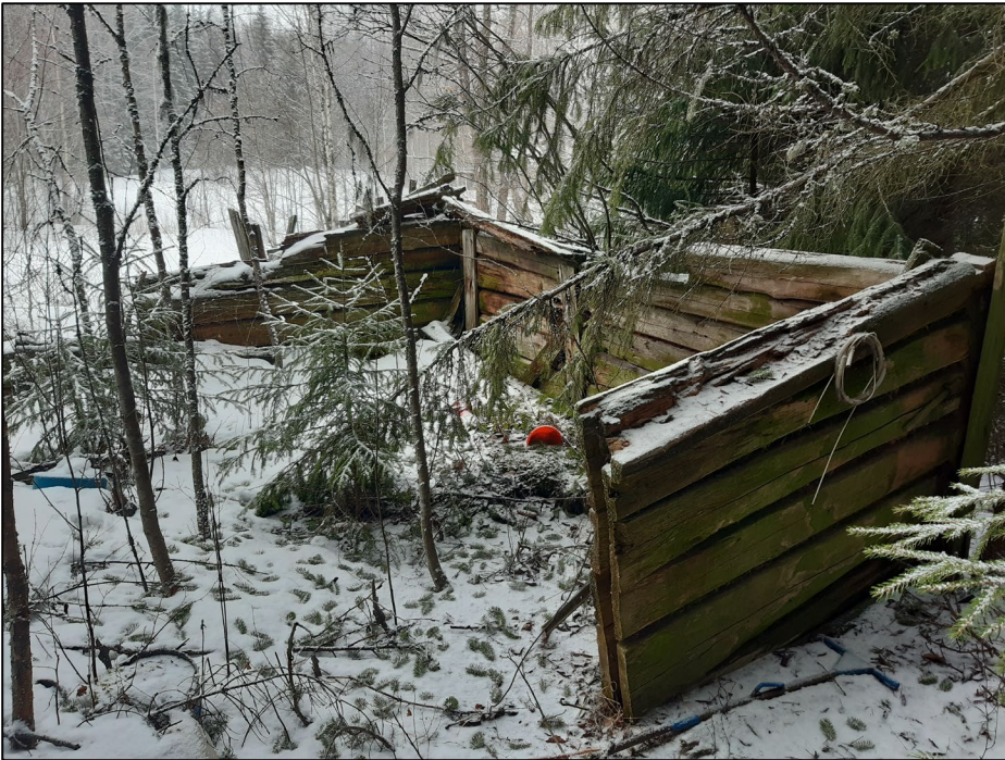
Kuva 13. Kiinteistöllä 418-439-3-4 sijaitseva asuinrakennus. Lähde: Lempäälän kunta 22.03.2023.
