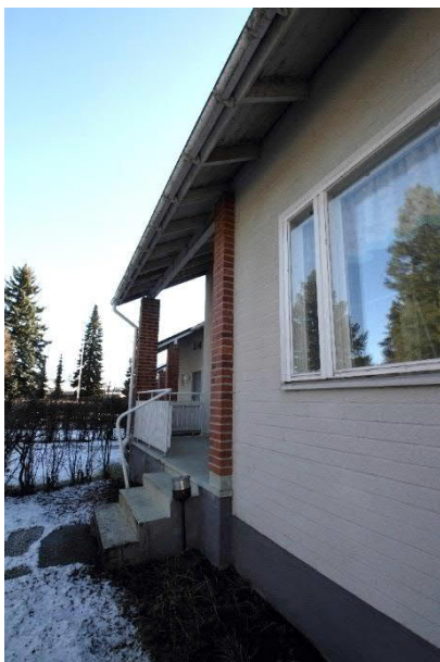
Kuva 54 Rivitalon asuntojen sisäänkäyntien yhteydessä on avoimet kuistit. Julkisivun porrastuksia rytmittää kuistien punatiiliset pilarit.
