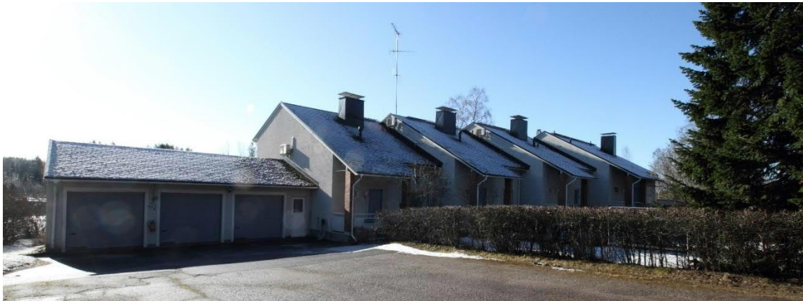
Kuva 53 Rivitalo, pitkä julkisivu; Rakennuksen arkkitehtoninen ilme on hyvin säilynyt, mutta koteloimattomat ilmalämpöpumput rikkovat ilmettä.
