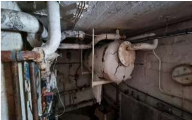
KUVA 13 Asbestipintaisia putkia ja laitteita teknisessä tilassa (Tuominen 2022)
