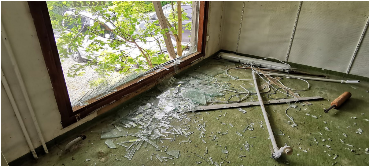
KUVA 10 Mymälän rikottu ikkuna (Nyström-Järvinen 2022)
