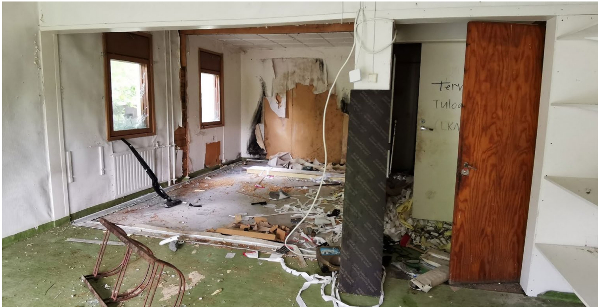
KUVA 11 Myymälätilaa, takaosassa tuli on turmellut seinäpintaa (Nyström-Järvinen 2022)
