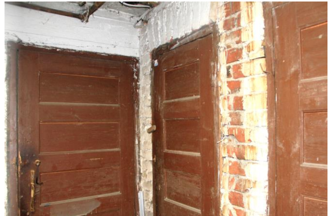
Kellarin varastohuoneisiin johtavat ovet ovat alkuperäisiä peiliovia. Kellarin kantavat rakenteet ovat betonia, mutta väliseinät ovat tiilistä. Kuva nro 6846
